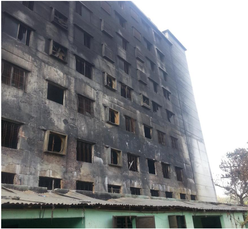
Gebäudefassade nach dem Brand
